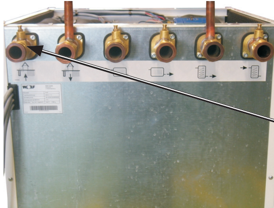
Handentlüfter im Sole-Eintritt
