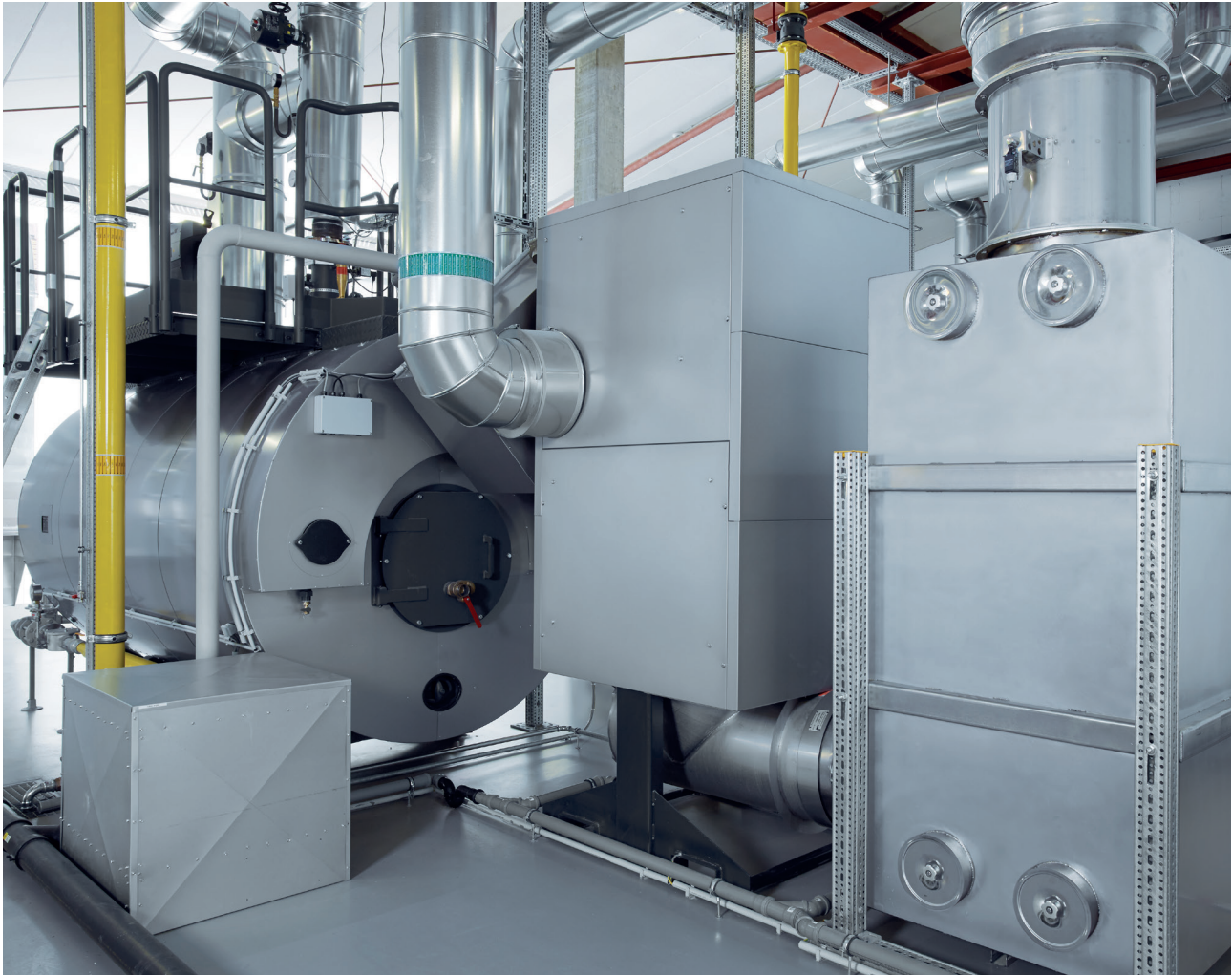
Abgas-/Wasser-Wärmetauscher entziehen den heißen Abgasen Wärme und nutzen diese zur Erwärmung von Wasserkreisläufen, wodurch die Effizienz der Anlage erhöht wird.
