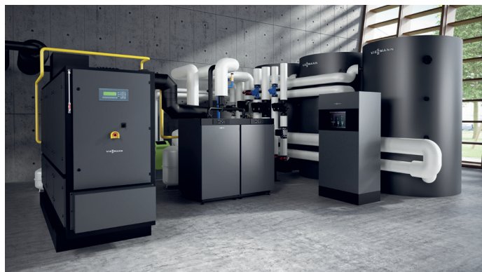
Die Energiezentrale des Neubauquartiers mit Blockheizkraftwerk, Gas-Brennwertkesseln, Heizwasser-Pufferspeichern und multivalenter Systemregelung
