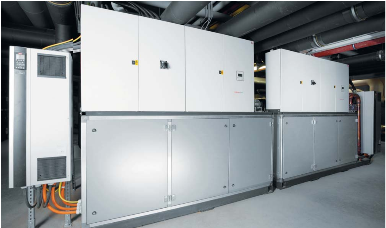
Die KWT-Wärmepumpen haben eine Leistung von 720 kW.
