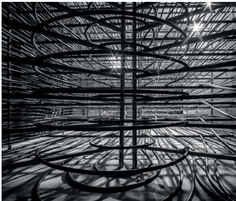
Das Wärmetauschersystem sorgt für kontrolliertes Einfrieren.
