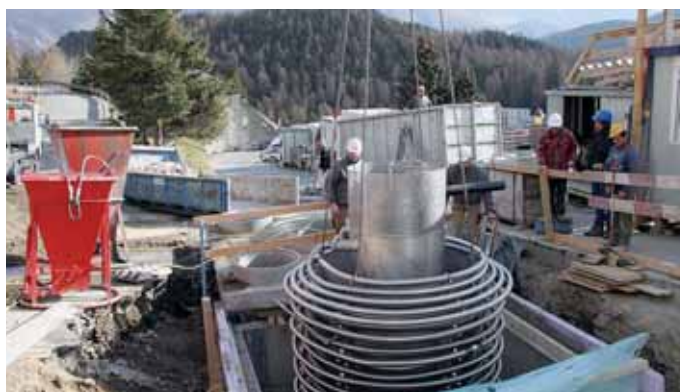
Dieser Abwasserschacht dient als Primärquelle zur Warmwasseraufbereitung.
