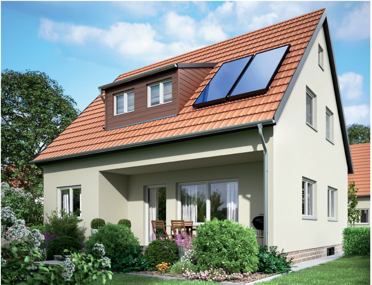
Vitosol 200-FM auf dem Dach eines Einfamilienhauses
