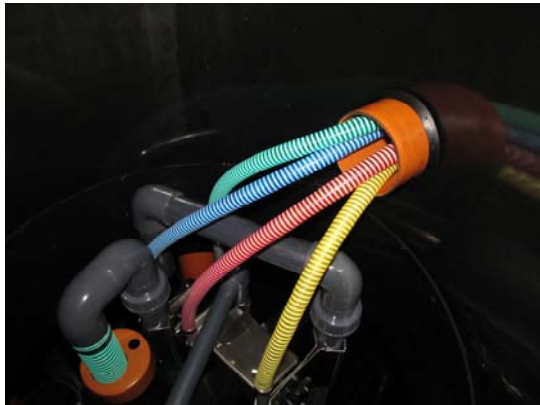
Anschluss für Leerrohr am Domschacht
