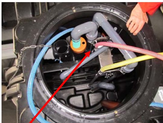
Roter Luftschlauch – Anschluss an Luftheber für Schlammrückführung
