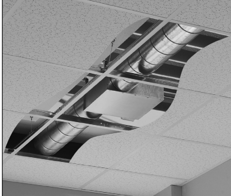
Abb. 8 Montage in abgehängter Decke. Direkt im Rohrverlauf.
