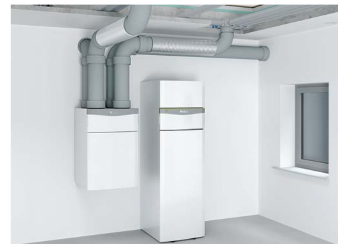
Zentrale Lüftung recoVAIR 260 mit flexiblem Luftkanalsystem
