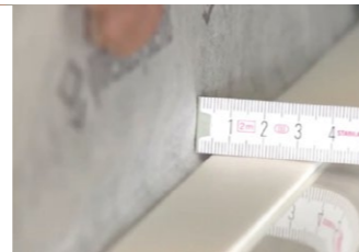
Zwischen der Außenkante des Dichtbandes und der Außenkante des Schutzbandes müssen 5 mm Fuge bestehen bleiben.
