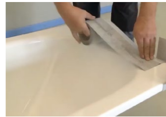
Anschließend wird das Wannenranddichtband ausgemessen. Am Wannenrandende schließt das Dichtband bündig ab.
