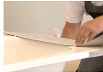
Das Dichtband wird am Wannenrand angeklebt und mit einem Meterstab fest und faltenfrei angedrückt.
