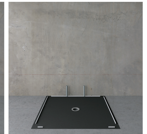
3. Einbau des Bodenelements und Anbringen der Verbindungsfedern für die Montage der Wandmodule im Bodenelement
