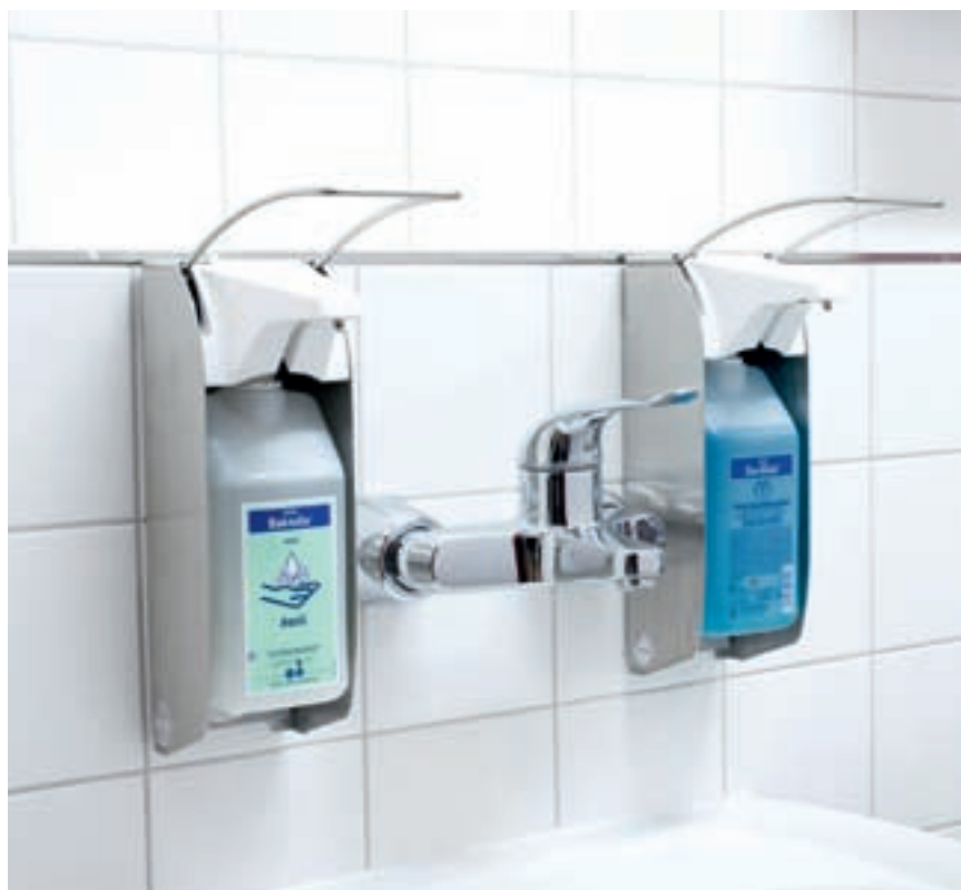
Über dem Waschtisch haben neben der schmalen Armatur noch zwei Dispenser Platz
