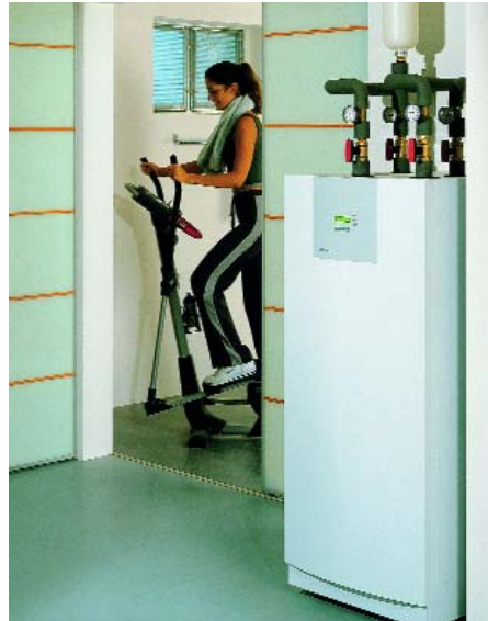
Innen aufgestellte Luft/Wasser-Wärme- pumpe mit Wassererwärmung
