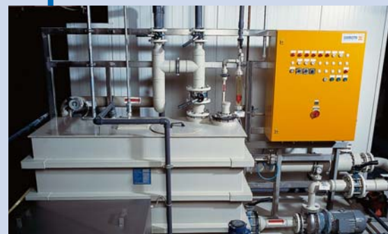
In der Mikrofiltrationsanlage werden Schlickerteilchen zurückgewonnen.
