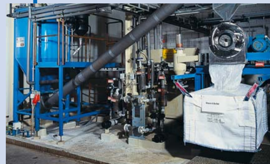
Die Kristallisationsanlage ermöglicht das Abscheiden von Eisenbestandteilen aus den Beizbädern.
