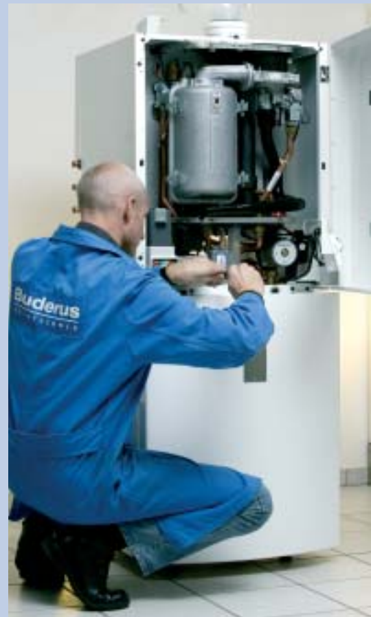
Kompakte Wärmezentrale: Der Gas-Brennwertheizkessel Logamax plus GB132 T mit 135 Liter Speicher.
