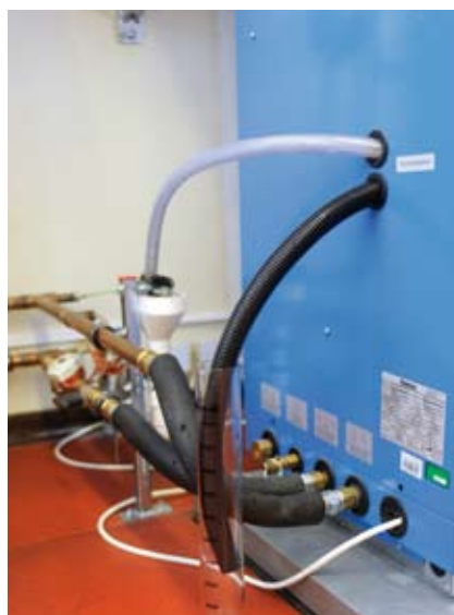
Erzeugte Wärme wird über ein Leitungssystem zur Erwärmung eines Speichers genutzt.
