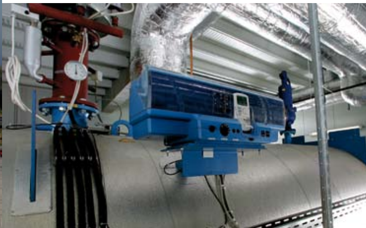
Die Regelgeräte Logamatic 4311 und 4312 für mittlere und große Heizungsanlagen regeln den Betrieb der Heizungsanlage im ISS DOME.
