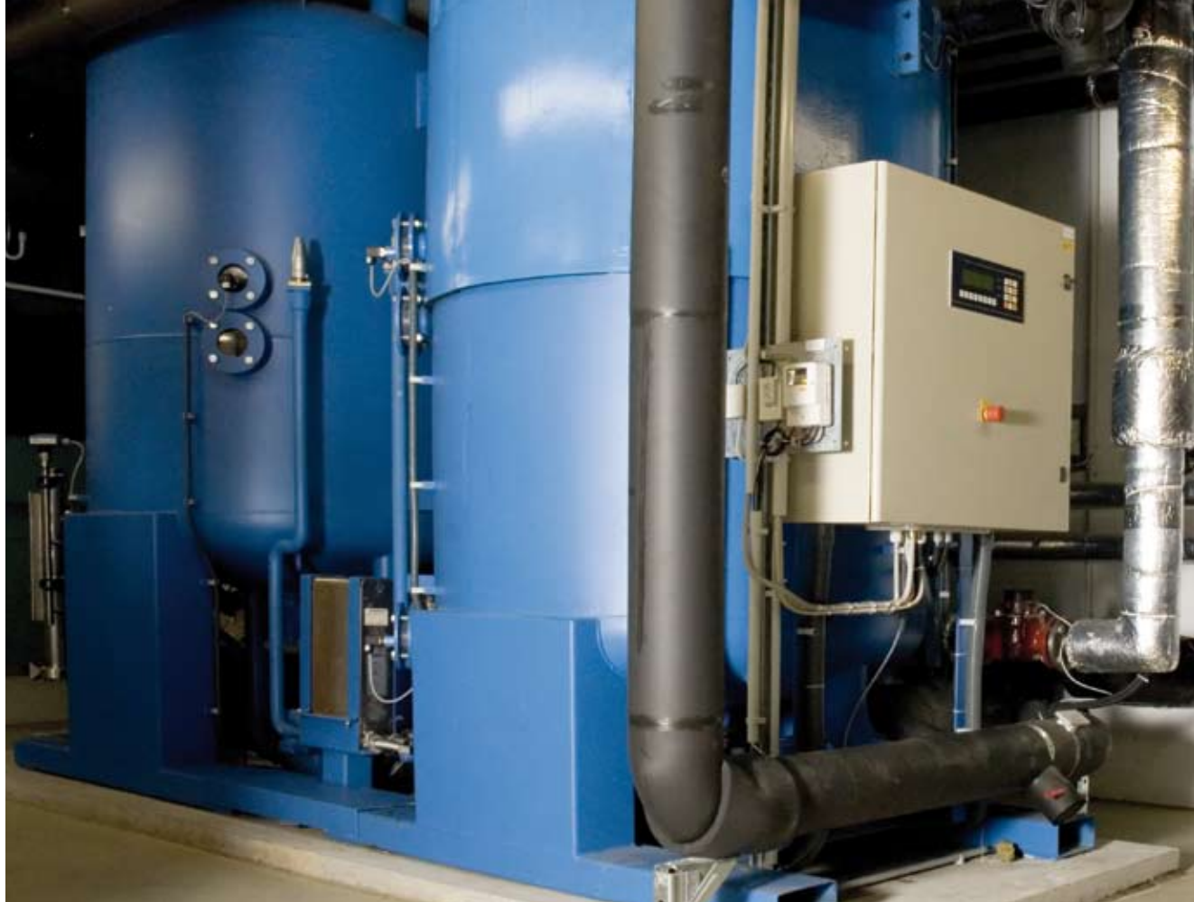
In Kombination mit einer Absorptionskälteanlage Loganova Trigen 150 sorgt das BHKW-Modul für Kälte zur Raumkühlung und für die Forschung.
