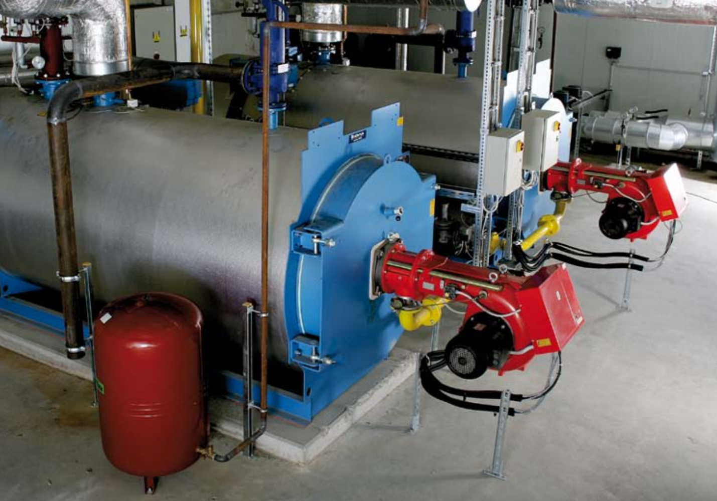
Zwei Buderus Niederdruck-Heißwasser-Stahlheizkessel Logano S825L versorgen den ISS DOME mit Heizwärme und warmem Wasser.
