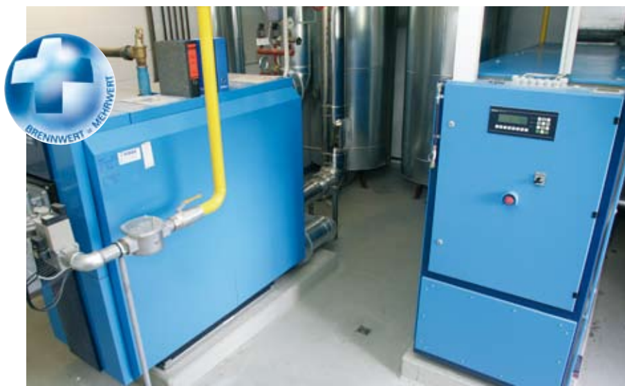
Geschlossene Mannschaftsleistung: Ein Loganova BHKW-Modul DN 50 und ein Gas-Brennwert-Heizkessel Logano plus SB615 erfüllen die Anforderungen im Sportpark Langenhagen.
