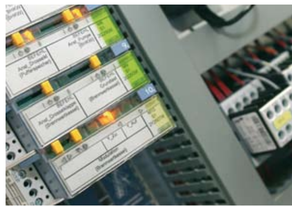
Moderne Regelungstechnik für einen effizienten Betrieb von BHKW und Gas-Brennwert-Heizkessel.
