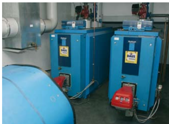
Ein neues Zeitalter in der Heizzentrale: Zwei Stahlheizkessel der Baureihe Logano SE decken den Bedarf der Klinik.
