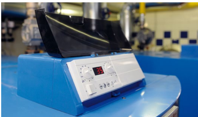
Die Kesselregelung setzt die Vorgaben der übergeordneten Regelung um und stellt einen optimalen und effizienten Betrieb sicher.
