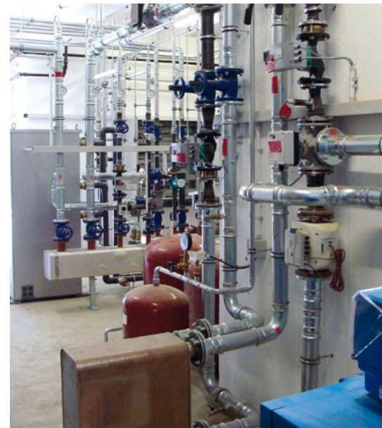
Das komplett neue Verteilsystem.
