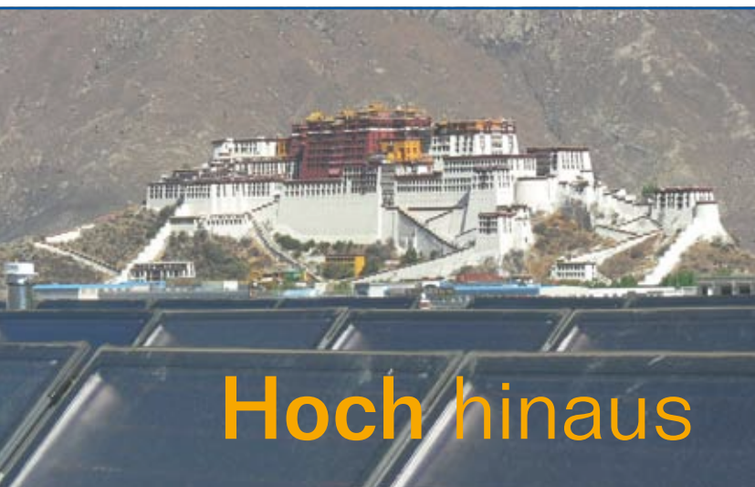
Solaranlage mit 174 Kollektoren auf dem „Dach der Welt“.
