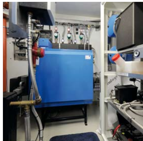
In Spitzenlastzeiten geht der Logano GE315 in Betrieb.
