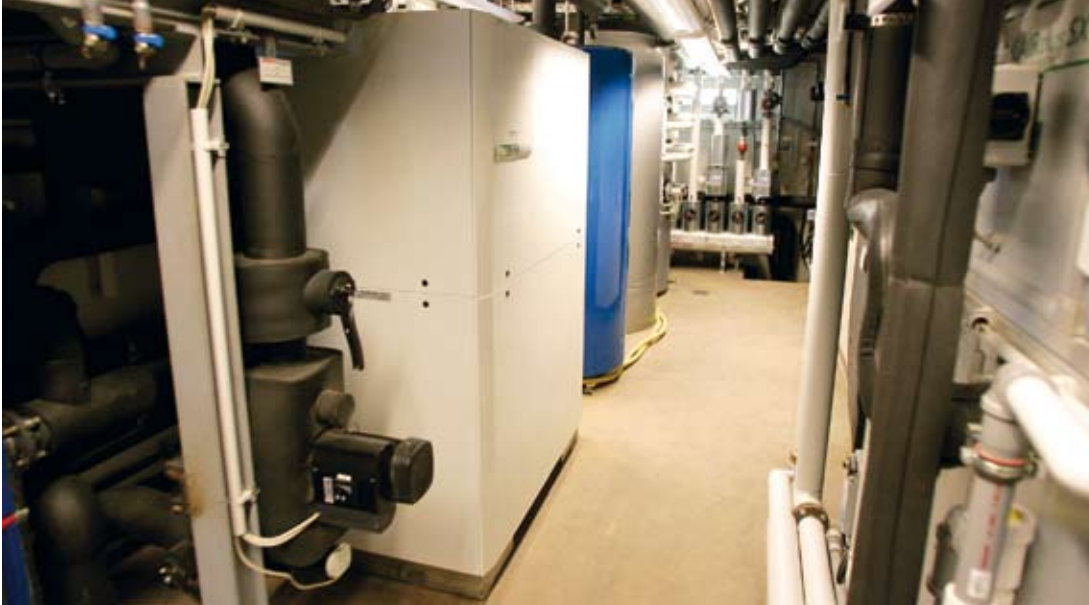
Auf kleinem Raum sind im Heizungskeller des neuen Wirtschaftsgebäudes alle Komponenten für die Wärmepumpenanlage untergebracht.
