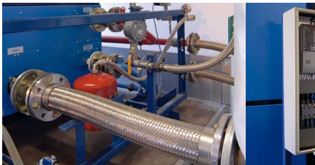
Die Verbindung mit den Anlagenkomponenten für Strom, Gas, Abgas und Heizkessel erfolgt über flexible Schläuche.
