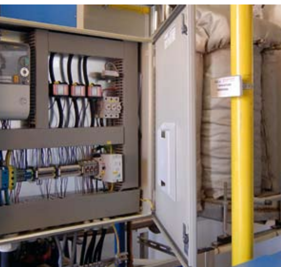
Die elektrischen Anschlüsse sind am mobilen BHKW modul DN50 fest installiert.
