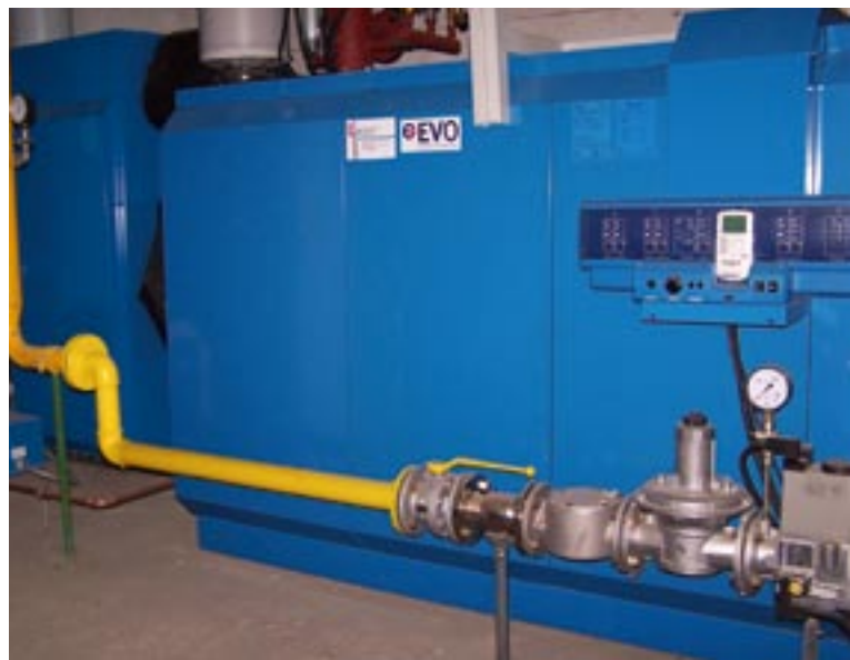
Ein Brennwertsystem Logano plus GE615 mit nachgeschaltetem Brennwert-Wärmetauscher, gesteuert von einem Regelsystem Logamatic 4311, versorgt die Wohnanlage Zauberberg.
