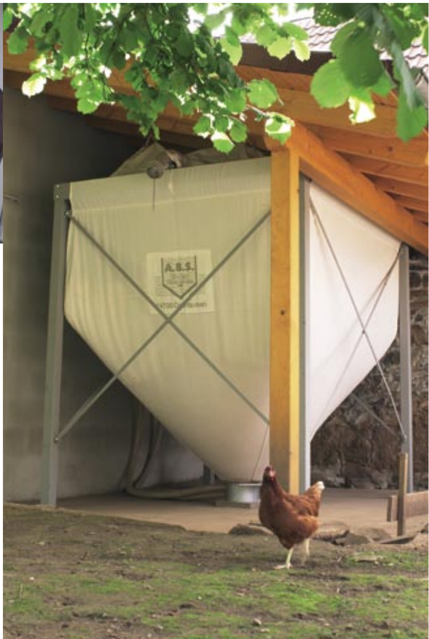
In einem Sacksilo außerhalb des Gebäudes sind die Holzpellets gelagert. Der Transport zur Heizungsanlage erfolgt vollautomatisch über eine Saugförderanlage – so steht immer ausreichend Brennmaterial zur Verfügung.
