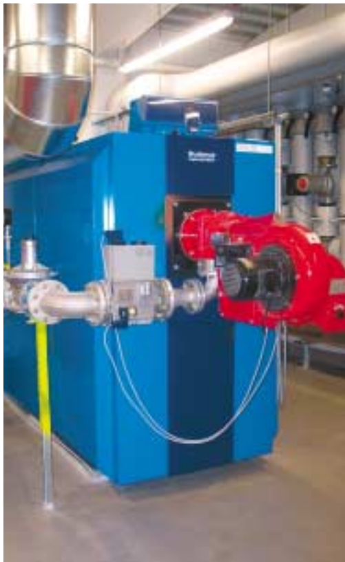
Für Wärme und Komfort sorgt am neuen Standort von Telair ein Logano plus SB615.
