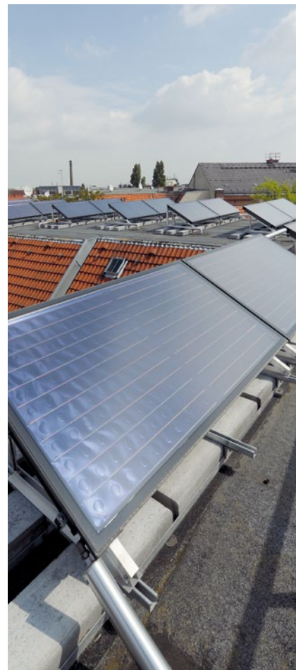
Solaranlagen rechnen sich in Mehrfamiliengebäuden – insbesondere in Kombination mit einem SAT-System.
