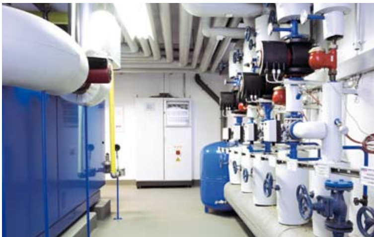
Über ein neues Verteilersystem wird die Wärme in die verschiedenen Gebäude des Industrieparks geleitet.
