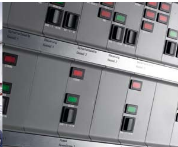
Ein Buderus Schaltschranksystem und drei Regelungen Logamatic 4212 sorgen für den optimalen Betrieb der Anlage.
