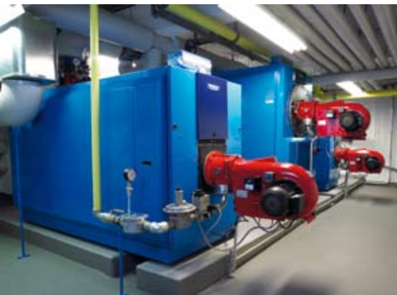
Eine neue Heizungsanlage mit einem Logano plus SB735 und zwei Logano GE615 versorgt den Industrie- und Technologiepark in Saarbrücken mit Heizwärme.
