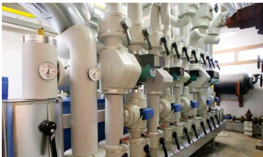
Über die Verteilstation werden Heizwärme und warmes Wasser an die verschiedenen Abnehmer im Mövenpick Hotel geliefert.
