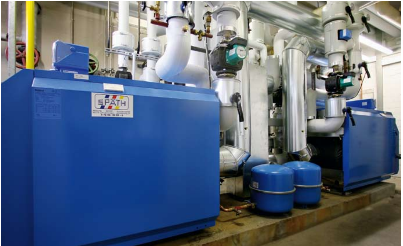
Eine nicht alltägliche Lösung im Heizraum des Hotelgebäudes: Die beiden Nieder-temperatur-Heizkessel Logano GE315 mussten aufgrund der örtlichen Gegebenheiten hintereinander aufgestellt werden.
