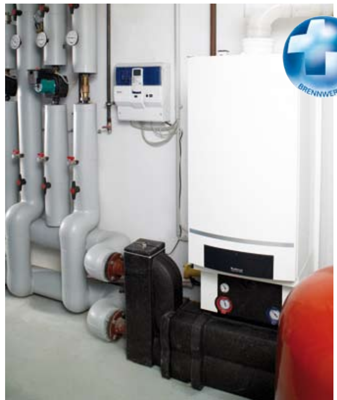
Kompaktes Kraftpaket: Im neuen Mehrfamilienhaus wurde ein Gas-Brennwert-Wandheizkessel Logamax plus GB162 mit 100 kW eingebaut.
