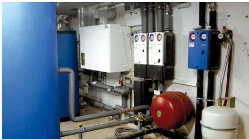
In der Kindertagesstätte auf dem Universitätsgelände wird der Gas-Brennwert-Wandheizkessel Logamax plus jetzt durch Sonnenkollektoren unterstützt.
