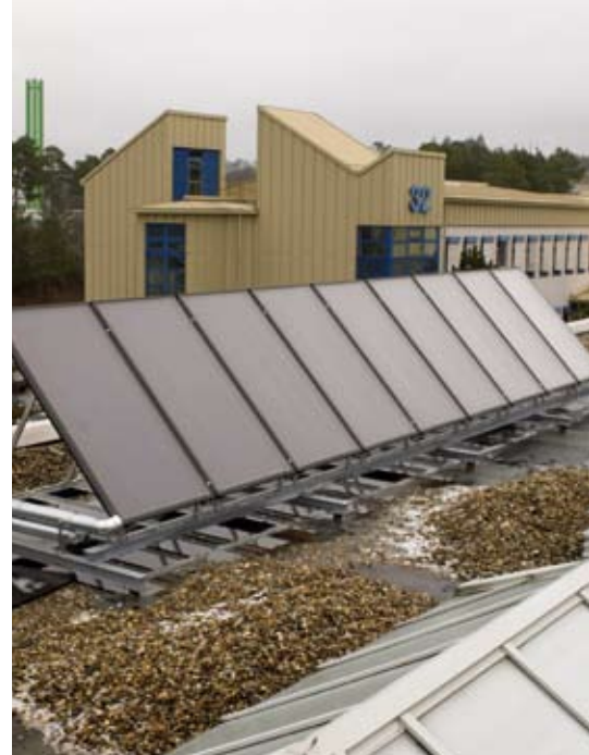
Die Uni Kaiserslautern setzt auf Sonnenenergie – hier auf dem Dach der Mensa.
