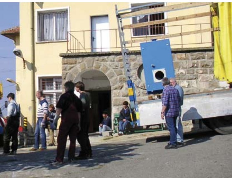
Gemeinsam packen die Fachleute an – jetzt sorgt der Logano SK625 für Wärme und warmes Wasser.
