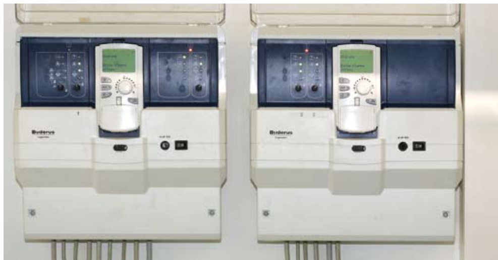
Moderne Regelungstechnik sorgt dafür, dass die neue Heizungsanlage effizient arbeitet.
