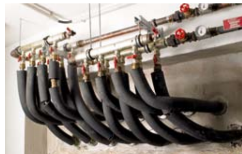
Ein Netzwerk aus Rohrleitungen verbindet das Schlammbecken mit der Wärmepumpe.
