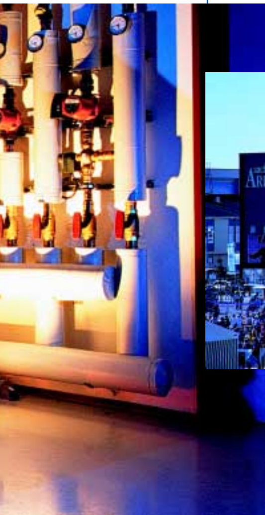
Moderne Heiztechnik für eine moderne Sportstätte: der Gas-Brennwertkessel SB315 U in der SachsenARENA.
