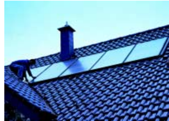
Solaranlagen, wie hier das System DIAMANT, gehören heute schon zum normalen Erscheinungsbild. Um die Technik unterzubringen, ist jedoch ein eigener Heiz- oder Technikraum erforderlich.
