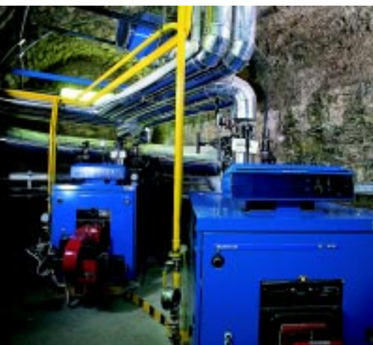
Einsparpotential Wohnungsbestand: Der Austausch veralteter Heiztechnik in Keller gewölben ist effektiver als das Aufspüren kaum noch erkennbarer Systemverluste im modernen Niedrigenergiehaus.
