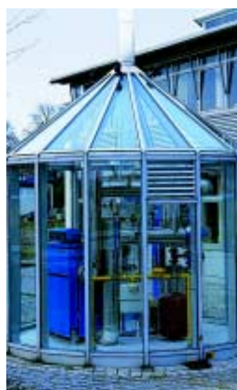
Ungewöhnlicher Standort: kein Ausstellungsstück hinter Glas, sondern eine Heizungsanlage im Einsatz.
