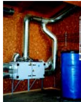
Kreuzstromwärmetauscher und solarthermischer Speicher im Ökohaus.
