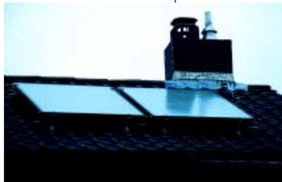
Das i-Tüpfelchen auf dem Dach: die Buderus- Kollektoren.
