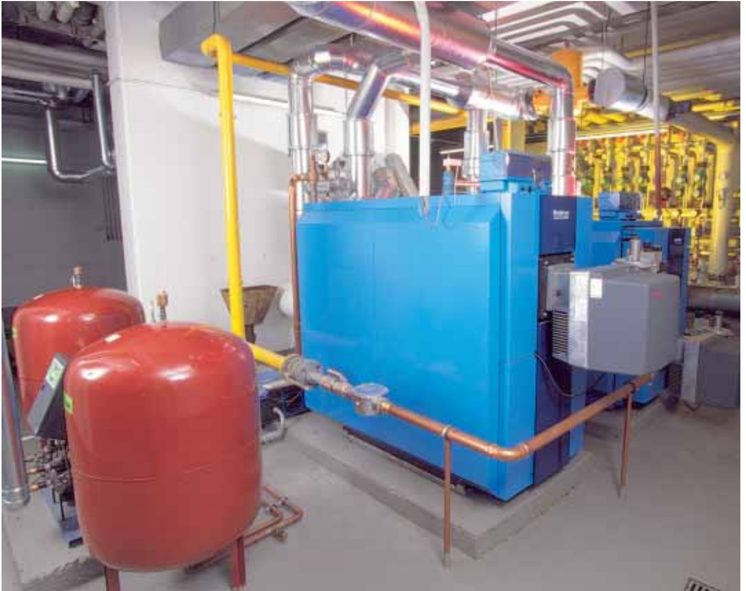
Ein starkes Team: Brennwert- und Niedertemperaturkessel bringen es zusammen auf eine stattliche Leistung von über 800 kW. Und sie sind sparsam. Im Vergleich zur alten Heizung wird bei ihrem Betrieb eine Senkung des Energieverbrauchs um ca. 20 Prozent erwartet.
