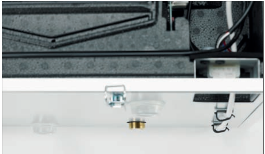
Kondensatanschluss am Gerät
