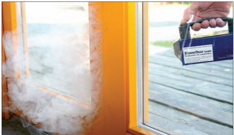
Bestimmung von Leckagen durch einen Nebelgenerator (Quelle: BlowerDoor GmbH)
