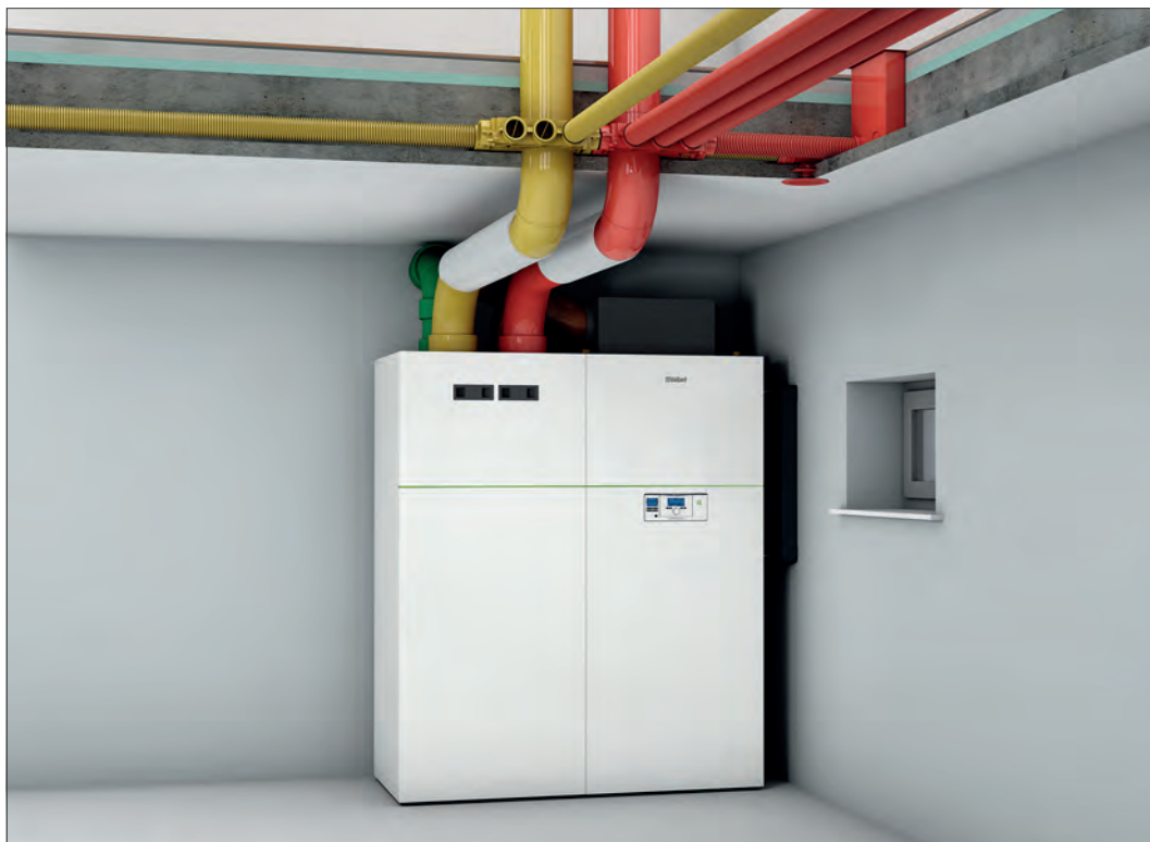
Abb 29: Installation in einem Haustechnikraum
