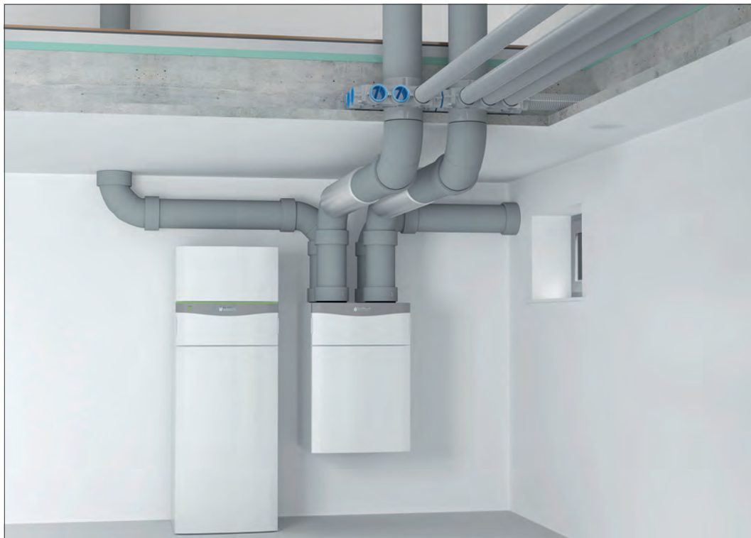
Abb 25: Installation im Keller
