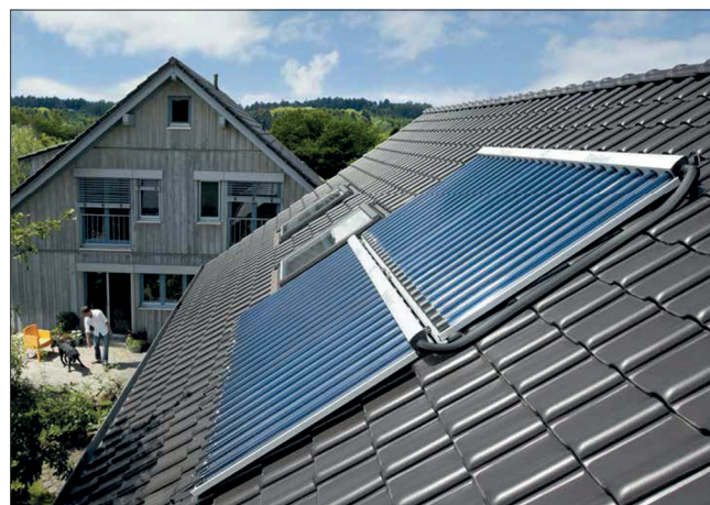
Abb 11: Nutzung von Solarenergie durch Röhrenkollektoren
