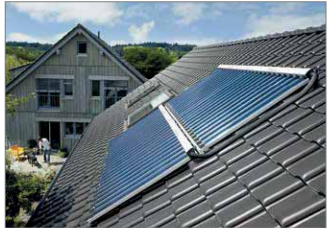
Abb. 26: Nutzung von Solarenergie durch Röhrenkollektoren
