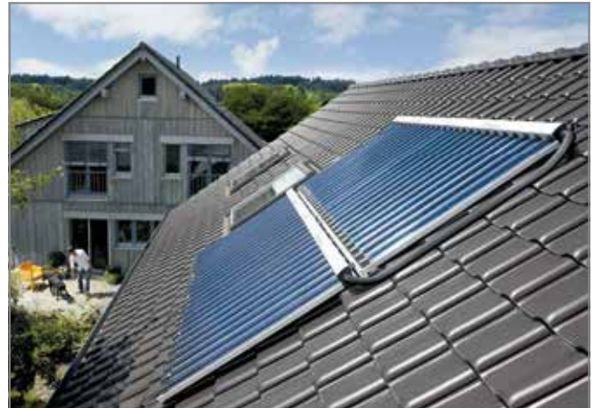
Abb 6: Nutzung von Solarenergie durch Röhrenkollektoren
