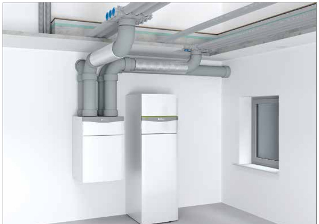
Abb 23: Installation im Erdgeschoss
