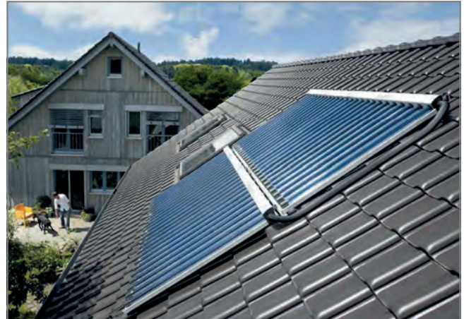
Abb 13: Nutzung von Solarenergie durch Röhrenkollektoren
