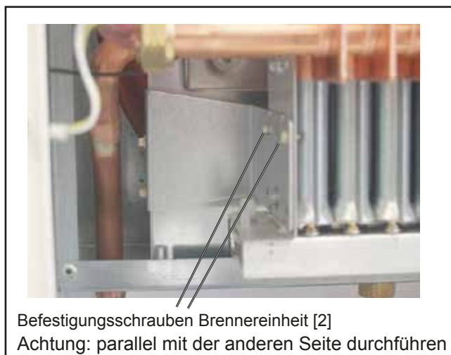
Bild: Reinigen des Gasbrenners
