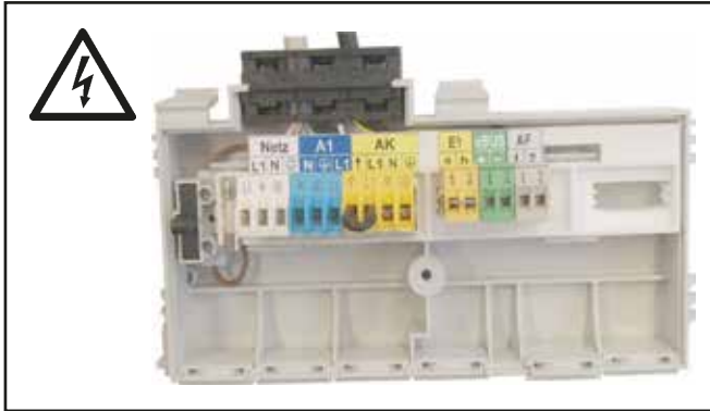
Bild: Klemmkasten, Gefahr durch elektrische Spannung
