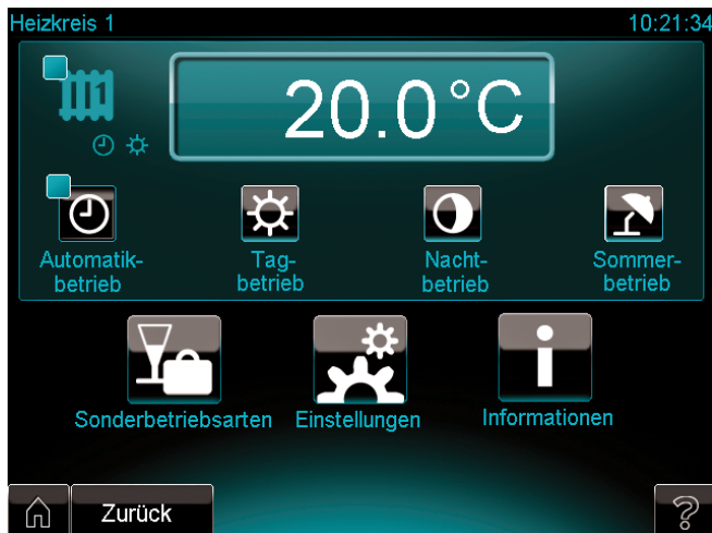
Abb. 8.8 Komponenten-Anzeige: Heizkreis (hier: Heizkreis 1)
