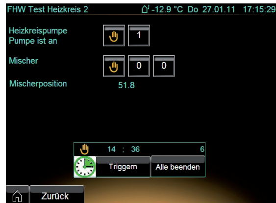
Abb. 6.26 Display Test Wärmeauskopplungsmodul
