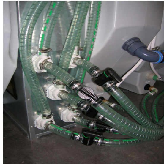
Tubería de aspiración + tubería de presión
