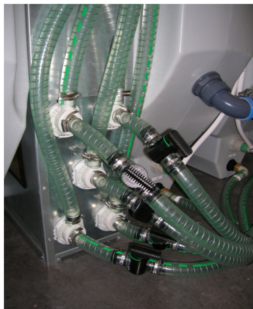
Conduites d'aspiration + conduites de refoulement
