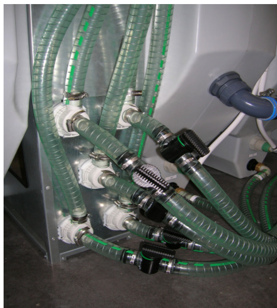
tubi di aspirazione + tubi di mandata
