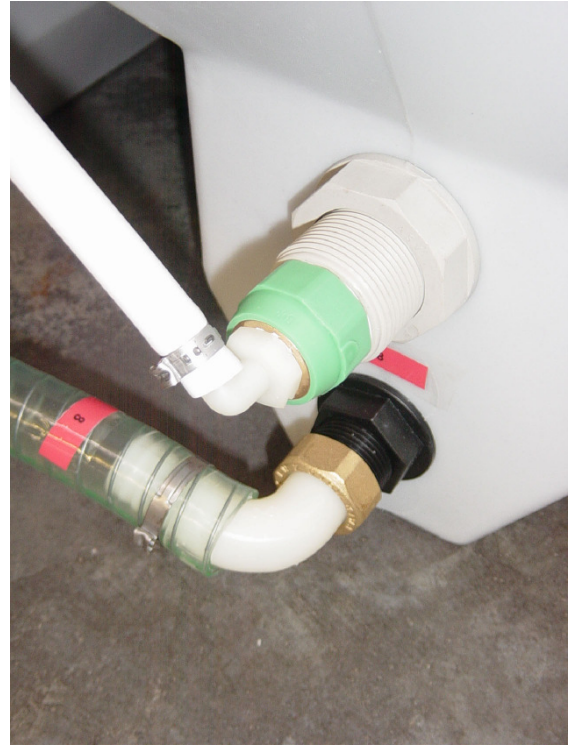
Conexión de la unidad de ventilación
