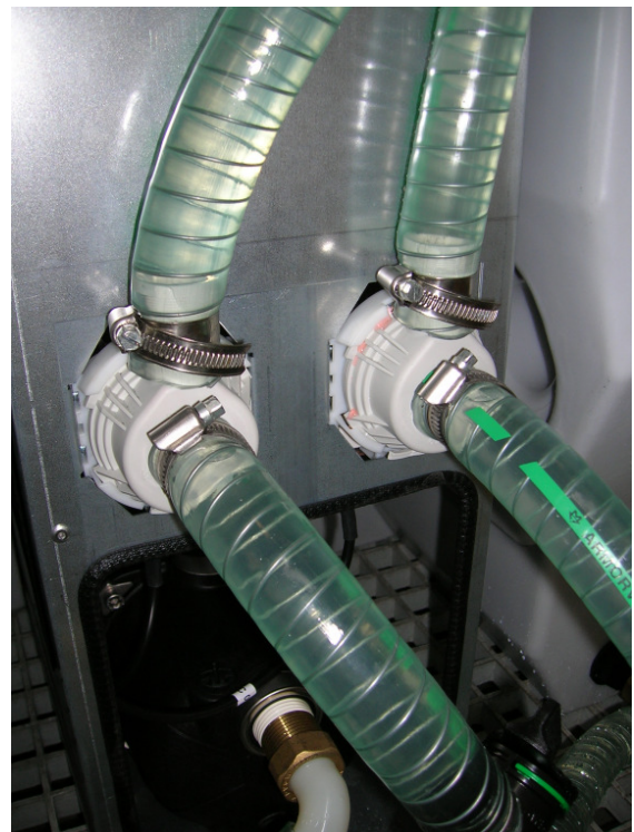
tubi di aspirazione + tubi di mandata
