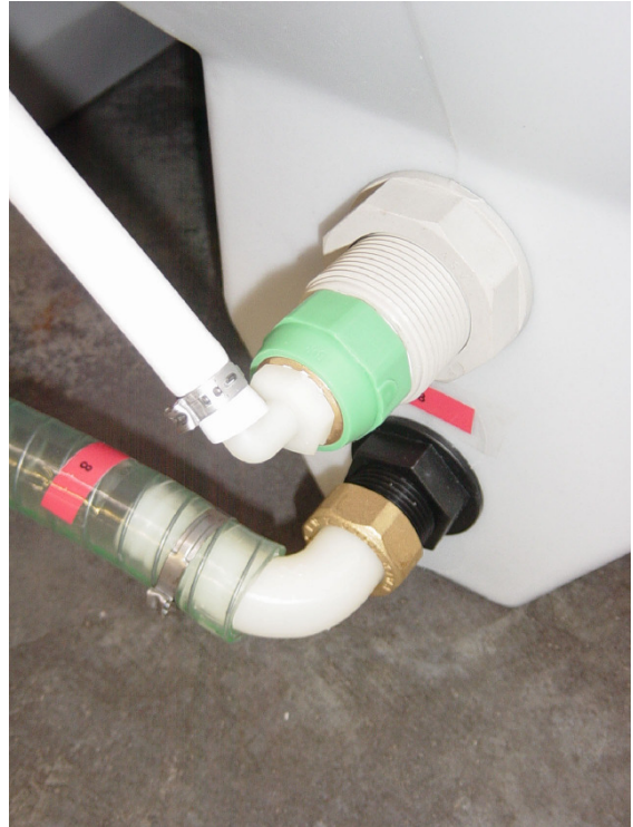
Raccord de l'unité de ventilation
