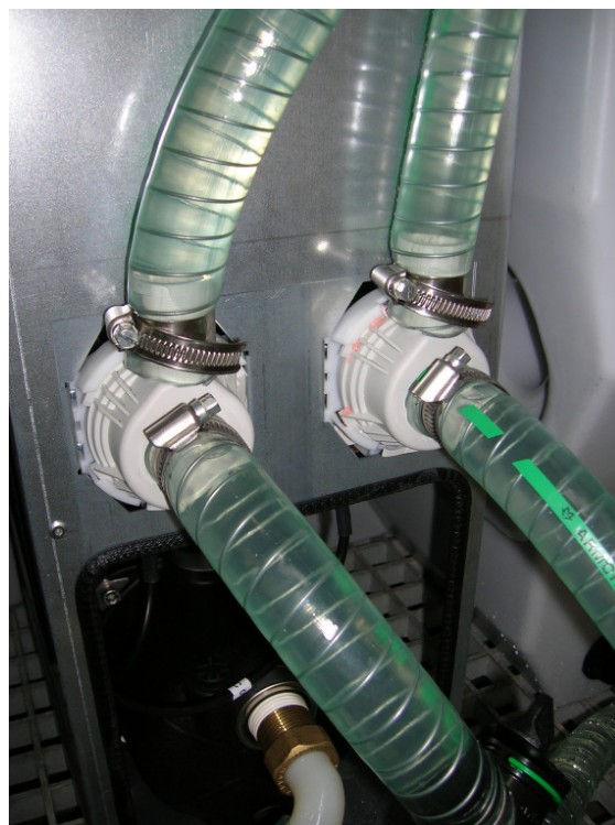
Tubería de aspiración + tubería de presión
