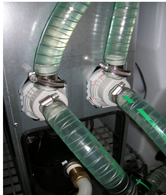
tubi di aspirazione + tubi di mandata
