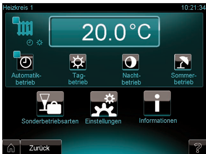
5.10 Komponenten-Anzeige Heizkreise (hier: Heizkreis 1)
