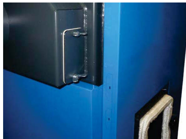
Steckverbindungen in der rechten Kesselabdeckung
