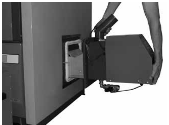
Entnahme des Brenners aus dem Kessel bei der jährlichen Wartung und Reinigung
