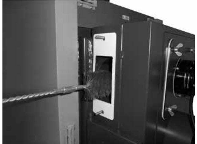
Veranschaulichung der Reinigung des Rauchkanals. Wird nach der Reinigung der Rohrwand über der Verbrennungskammer des Kessels durchgeführt
