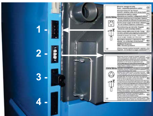
Steckverbindungen in der rechten Kesselabdeckung
