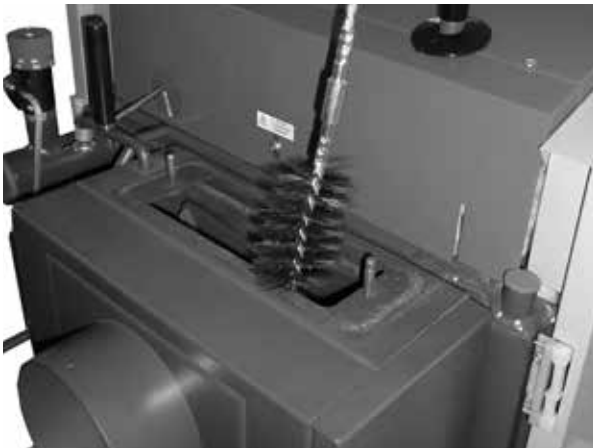
Muster – die Reinigung des Rauchkanals durch Putzbürste - oberer Putzdeckel.
